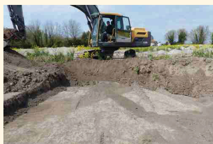
Fig. 3 : réalisation d'une « fenêtre » destinée à comprendre l'organisation des fossés (photo C. Vacher, Inrap)
